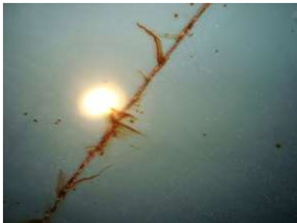
Figura 111 - Algumas fissuras detectadas na zona da junta de dilatação da cisterna
