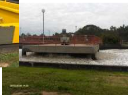
Figura 24 - Tanque de Arejamento
