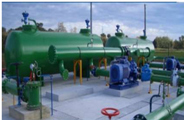
Figura 7 - Centro de Produção de Santo André Estação Elevatória do Moinho Novo
