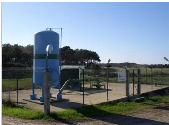
Figura 5 - Captação Subterrânea tipo (Porto de Peixe)
