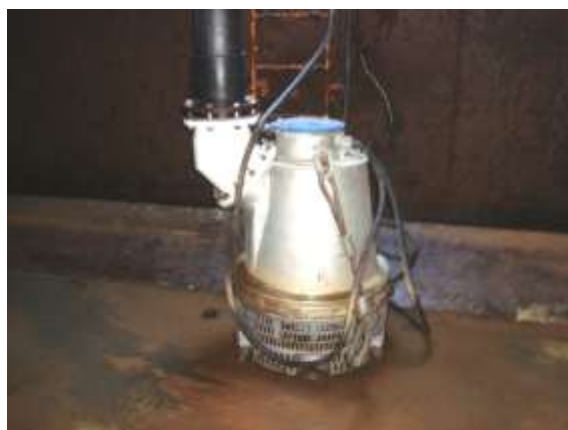
Figura 109 - Bomba Flygt – Modelo BS 2250.010/11 - Capacidade 230l/s – Utilizada para esgotar a cisterna
