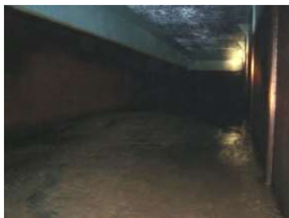
Figura 110 - Lama acumulada na galeria de entrada da cisterna
