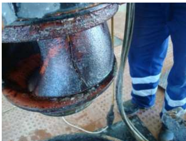
Figura 113 – Após desacoplamento, verificou-se que o impulsor se encontrava partido
