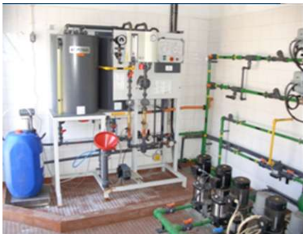
Figura 9 - Centro Operacional de Santo André Gerador de Dióxido de Cloro
